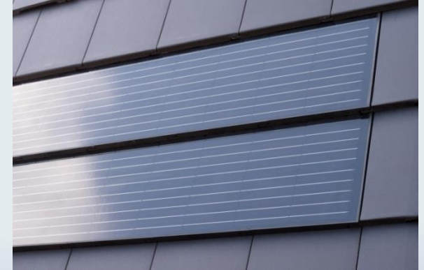
Gebäudeintegrierte PV (BIPV)
